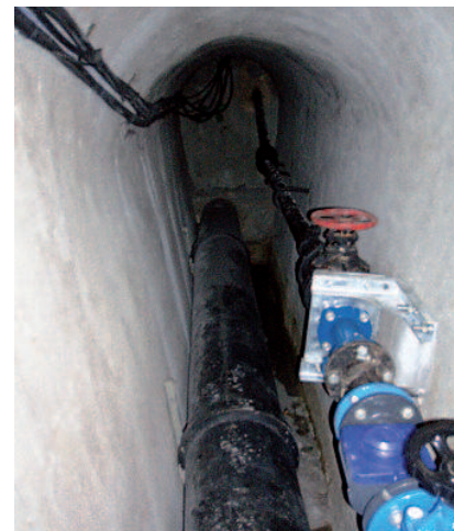
Adduction via les égouts.
